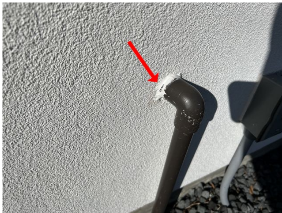
Seal penetration sprinkler conduit
